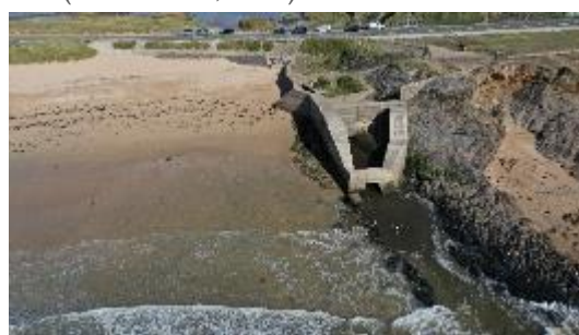
Figure 10 : Ci-contre vue aérienne du Petit Loc'h. Ci-dessous vue aérienne de l'ouvrage de débouché en mer de la Saudraye (ART&FACT, 2021)
