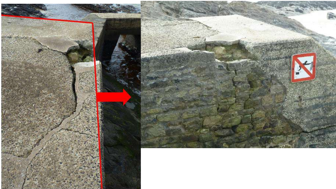
Figure 36 Dégradation progressive d'une partie de l'ouvrage
